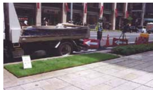
芝生による緑化で路面温度低減の実証実験 (場所:日本橋、写真提供(株)未来緑化)
